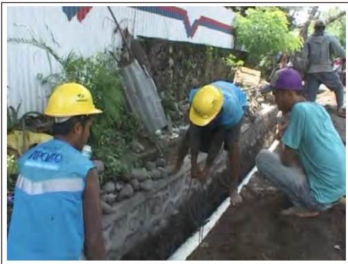
Jaringan Pipa Air Minum Kota Mataram
